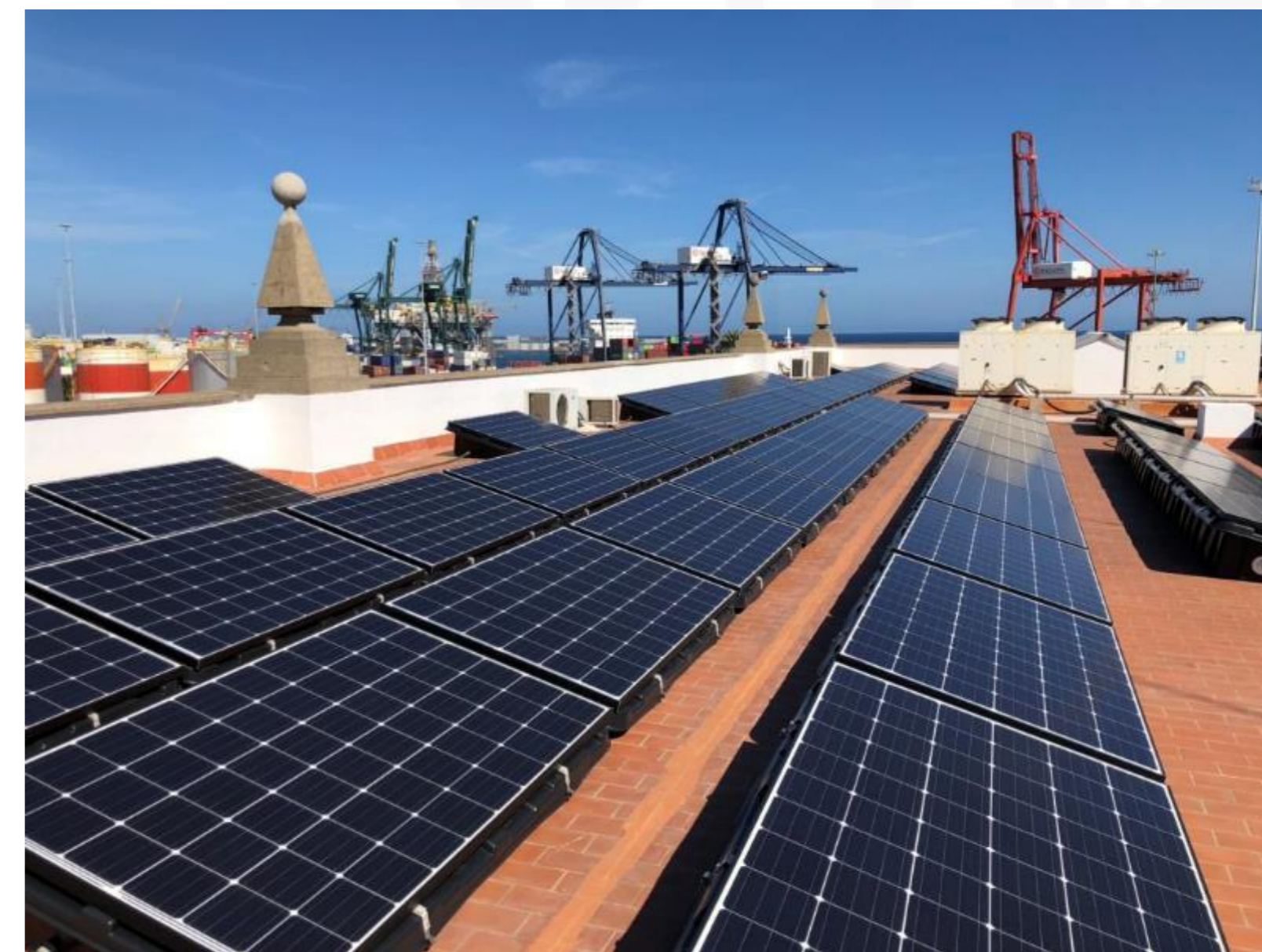
Energía solar fotovoltaica en la Autoridad Portuaria de Las Palmas
